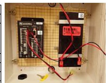
内部は、C-CR300通信装置と鉛電池のみとシンプルな構造
